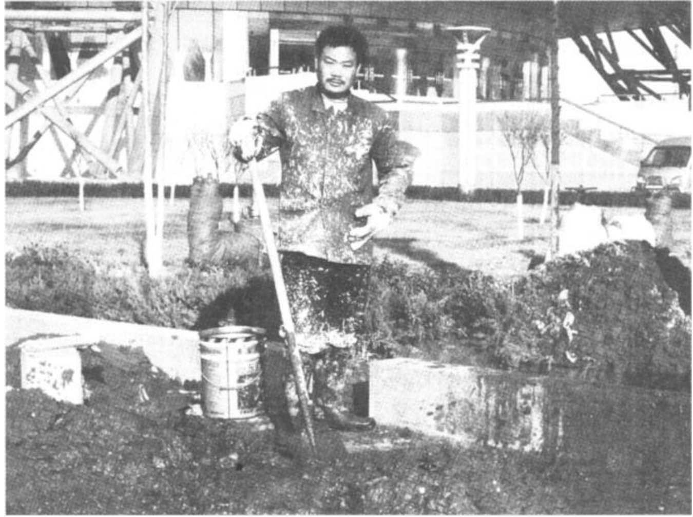
元月1日，油城广场内的一处供热管道发生破裂，维修师傅在忙碌的一天中过了元旦。（本报记者 李波 摄）
